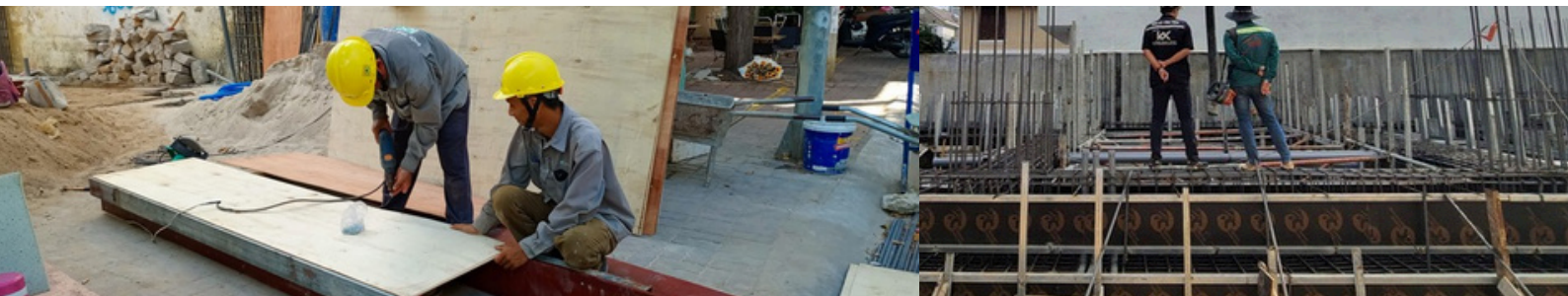
Hình ảnh: Ván khuôn được ghép cẩn thận kín, khít, đảm bảo nước & xi măng không chảy ra ngoài
