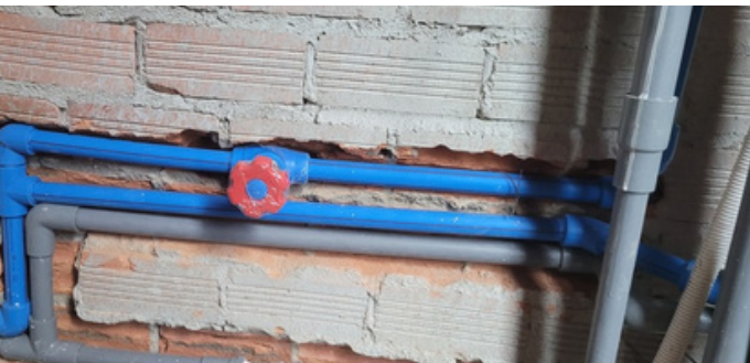
Hình ảnh: Ống nước âm sử dụng ống PPR
