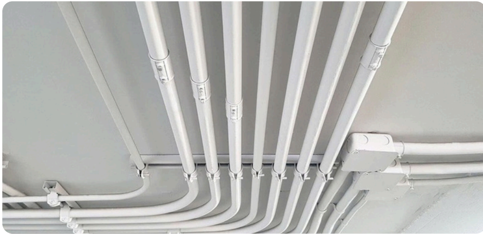
Hình ảnh: “Hệ thống ống điện đi nổi trần được lắp đặt đúng kỹ thuật cố định bằng kẹp chuyên dụng đảm bảo an toàn và thẩm mỹ.”
