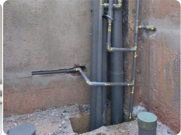
Hình ảnh: Ống đi nổi được đánh dấu
